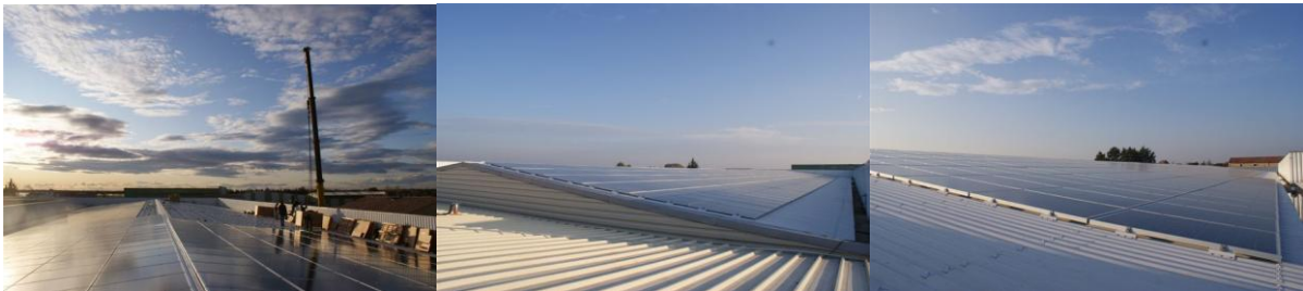
La centrale solaire photovoltaïque sur la toiture de Duo Industrie à Lansargues (Hérault)
